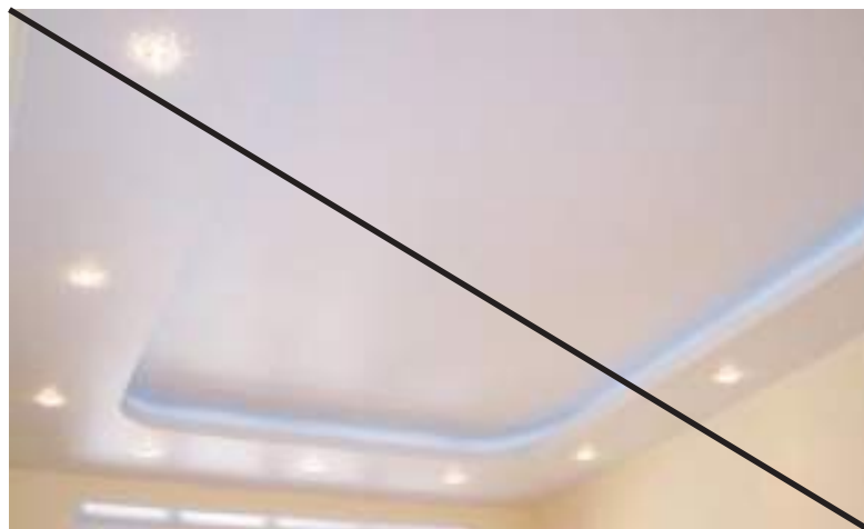
Плохо Многоуровневые гипсокартонные конструкции
